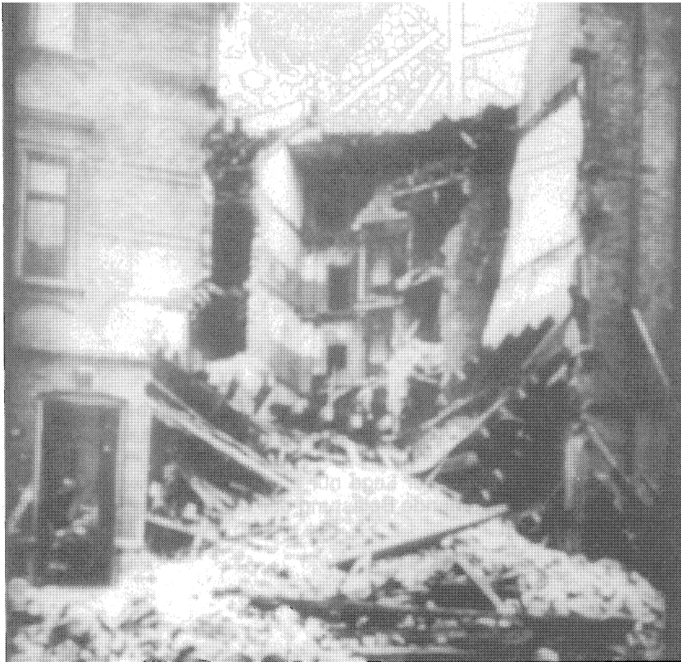
V-förmig angeordnete Rutschflächen eines total zerstörten Gebäudes
