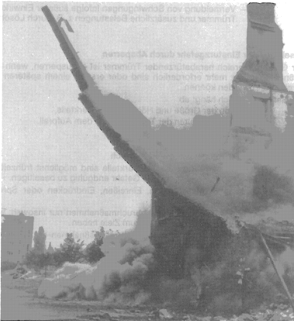
Freistehendes Wandteil während des Einsturzes
