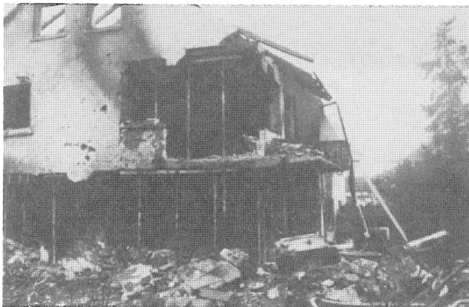
Infolge Flugzeugabsturz zusammengebrochenes Gebäude
