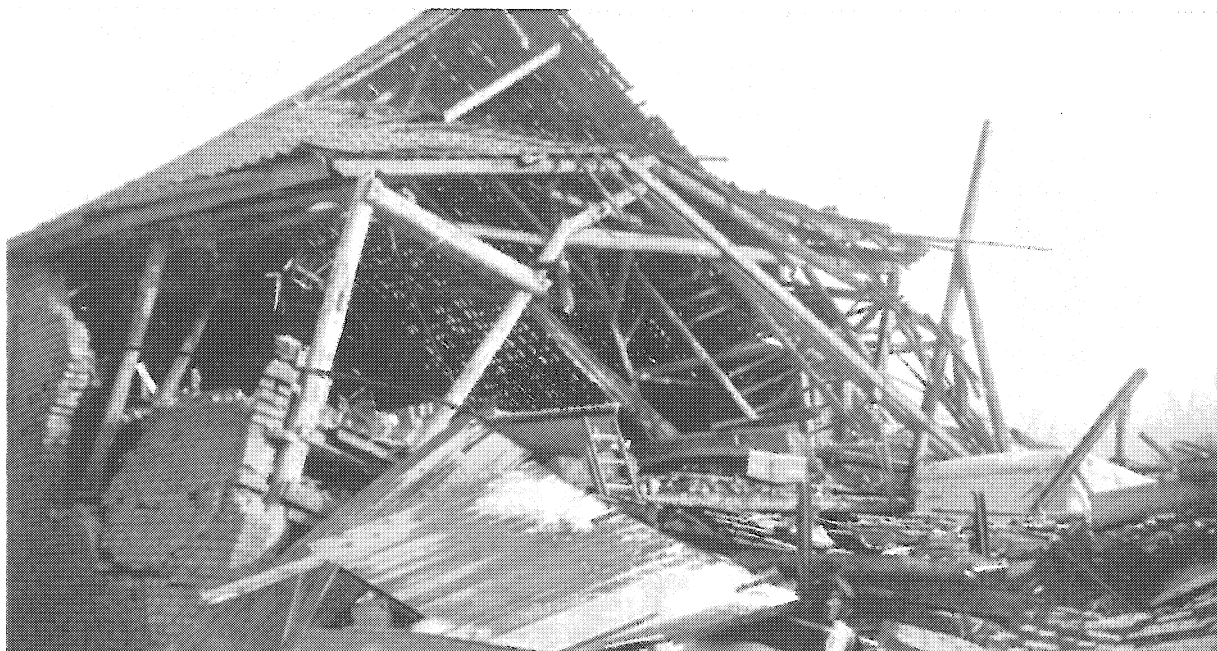
Durch einen Orkan zusammengebrochenes Lagergebäude
