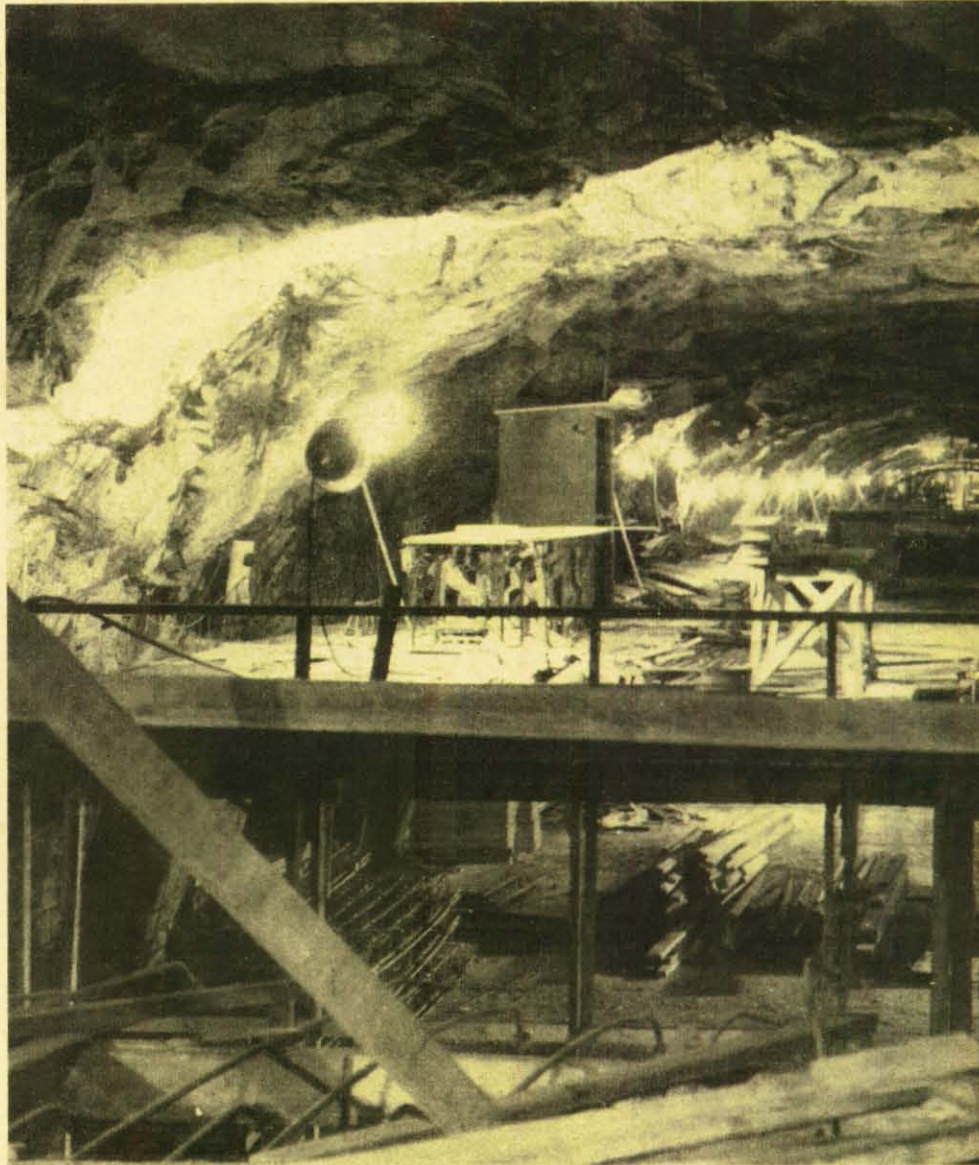
Der größte Bergräum Stockholms hat drei Etagen. Er kann sogar 20 000 Menschen aufnehmen. Die Kosten belaufen sich auf 12 Millionen Kronen. \frac{1}{3} dieses Betrages trägt die Stadt Stockholm, \frac{2}{3} der Staat. Auch dieser inzwischen fertiggestellte Bergräum wird heute als Garage vermietet und bietet 650 Wagen Platz. Auf diese Weise wurden zwei Probleme gleichzeitig gelöst. Im Ernstfalle können viele Menschen vor dem sicheren Verderben gerettet werden. In friedlichen Zeiten aber ist der Raumnot in den Straßen erheblich abgeholfen.
