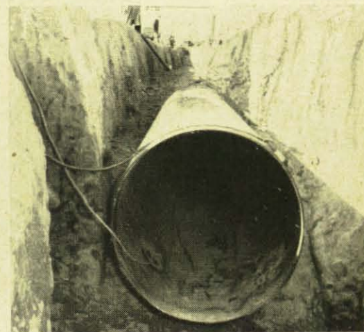
Bodenseewasser aus 60 m Tiefe soll durch dieses Rohr in ein 300 m höhergelegenes Filterwerk gepumpt und dann 150 km weit nach Stuttgart geleitet werden. Der Bodensee ist nämlich noch verhältnismäßig sauber.
