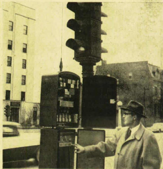
850 000 Fahrzeuge passieren täglich die LaSalle Street in Chicago. 13 Verkehrsampeln befinden sich auf dieser Strecke, die sämtlich durch Funk gesteuert werden. Unser Bild zeigt das Gehäuse, in welchem sich Sender und Empfänger befinden.
