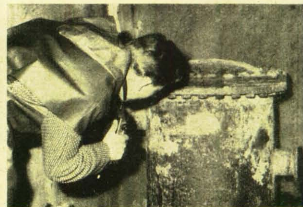
Feuchtigkeit, Rost und Schimmel haben von der Inneneinrichtung des Stollens wenig übriggelassen. Dieser schwere Zylinder der Entlüftungsanlage hat allerdings standgehalten. Viele andere Dinge jedoch müßten wieder erneuert werden.
