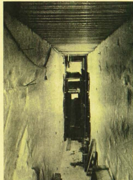
An kleinen Tunnelstrecken verschiedener Größe und Formen werden im Dauer-versuch Temperaturen sowie Konstruktionen und Deformationen des Querschnitts gemessen und die Erfahrungen beim Bau der nächsten Teilstrecke berücksichtigt. Die Menschen arbeiten hier unter härtesten Bedingungen.
