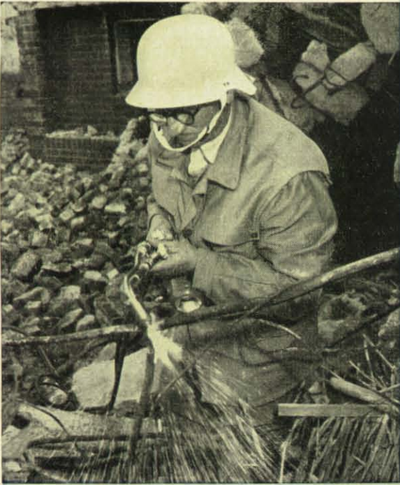
Links: Betoneisen, Leitungsrohre und andere metallene Gegenstände, die den Luftschutz-Bergungshelfern bei ihren Arbeiten im Wege sind, können mit dem Brennschneider Stück um Stück herausgeschnitten werden.
