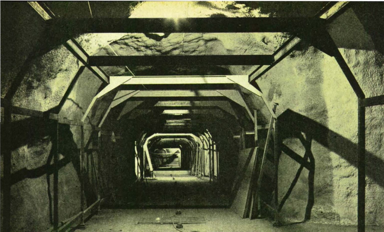
Oben: Blick in den Stollen. Die Wände sind gegen das Eindringen von Bergwasser abgedichtet. Die Träger-elemente bilden das „Haus im Haus“.
