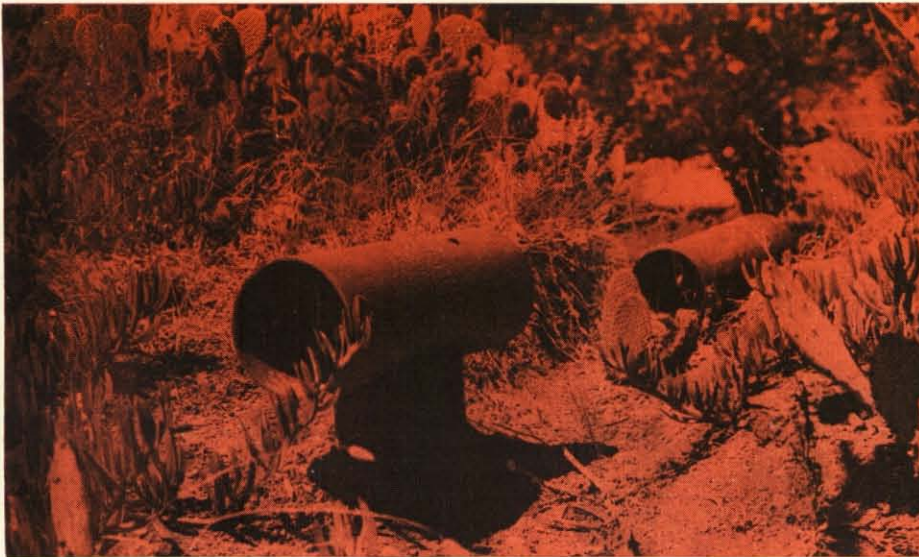
Dem Fremden kommt es eigenartig vor, wenn er zwischen Kakteen und tropischen Pflanzen Entlüftungsrohre eines Schutzraumes herausragen sieht.
