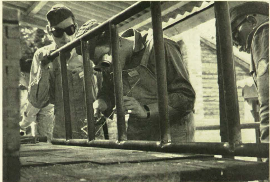
Oben: Die Rohrleiter für den Heißwasserbereiter wird zusammenschweißt. Unten: Die Brauseköpfe der Duschanlage sind aus Milchdosen hergestellt.
