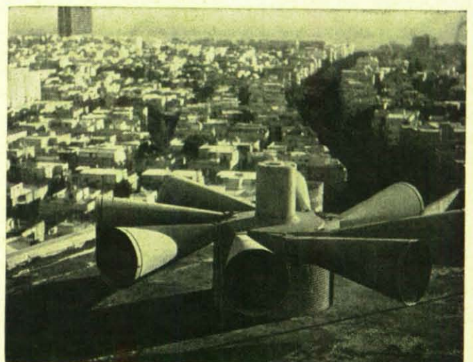
Vielfach ertönen die Sirenen nur zu Probealarmen. Diese französische Sirene — in Israel aufgestellt — mahnt die Bevölkerung im Ernstfall.
