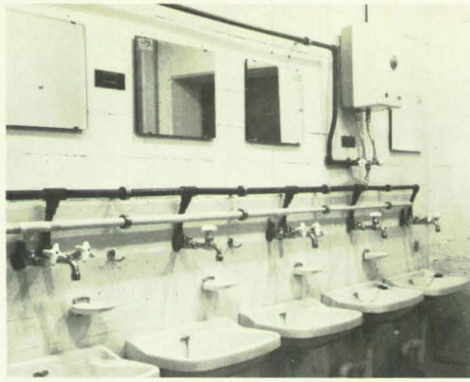
Ausreichende Waschgelegenheiten sind bei längerem Aufenthalt im Schutzraum Voraussetzung.
