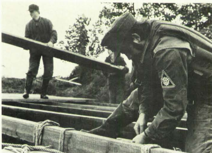
Ideale Ausbildungsmöglichkeiten bietet die Katastrophenschutzschule des Bundes, Außenstelle Hoya, bei Lehrgängen im Behelfsbrückenbau, Fahren auf dem Wasser sowie im Bau von Fähren und Schwimmbrücken.
