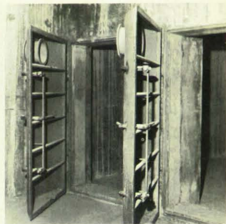
Zwei druckfeste Schleusentüren.
