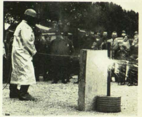
Das Durchbrennen eines Betonklotzes mit Hilfe der Sauerstofflanze ist für die Zuschauer immer wieder eine faszinierende Angelegenheit.
