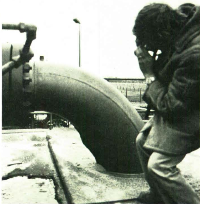
Das Leck im Leitungsrohr, aus dem das Öl ausströmte.
