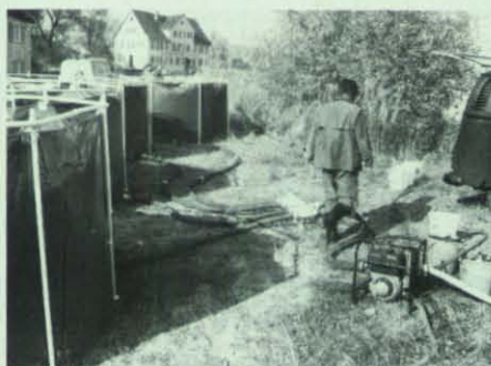
Rohwasserbehälter und Förderpumpe der Trinkwasseraufbereitungsanlage.
