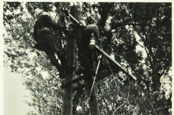
12 m A-Mast wird als Endpunkt einer Freileitung (Übergang auf Erdkabel) durch Angehörige einer E-Gruppe armiert.
