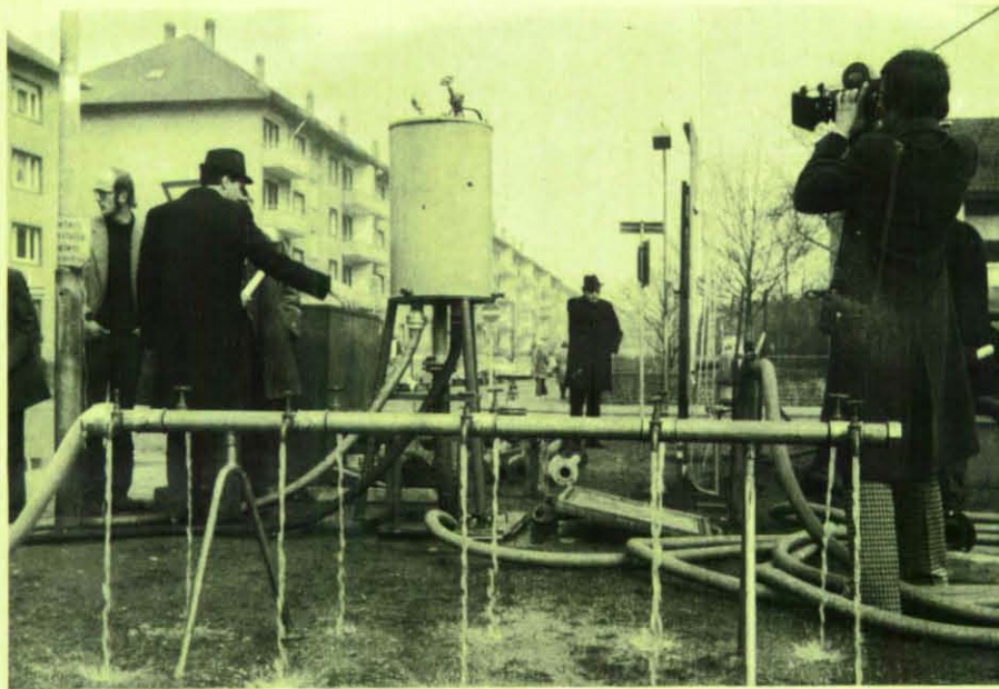
Aufbau eines Brunnens nach dem Lufthebeverfahren in einer Karlsruher Straße. Aus zehn Zapfstellen fließt das Wasser.
