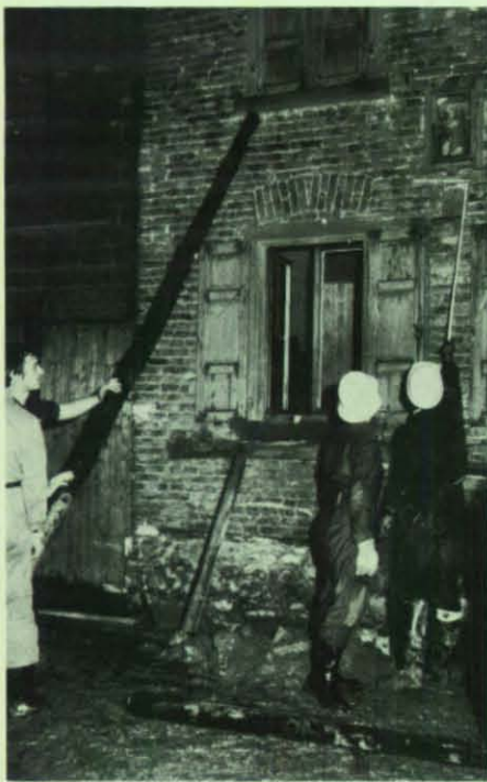
In Ebersheim konnte das THW ein fast völlig unterspültes Haus vor dem Einsturz bewahren.
