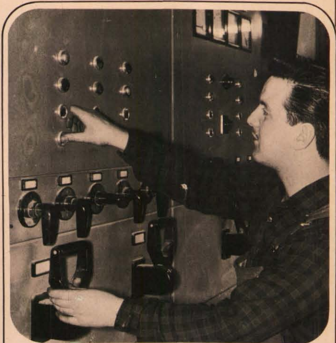
Arbeiten an der Schalttafel für die Starkstromversorgung im unterirdischen Teil eines Warnamtes.
