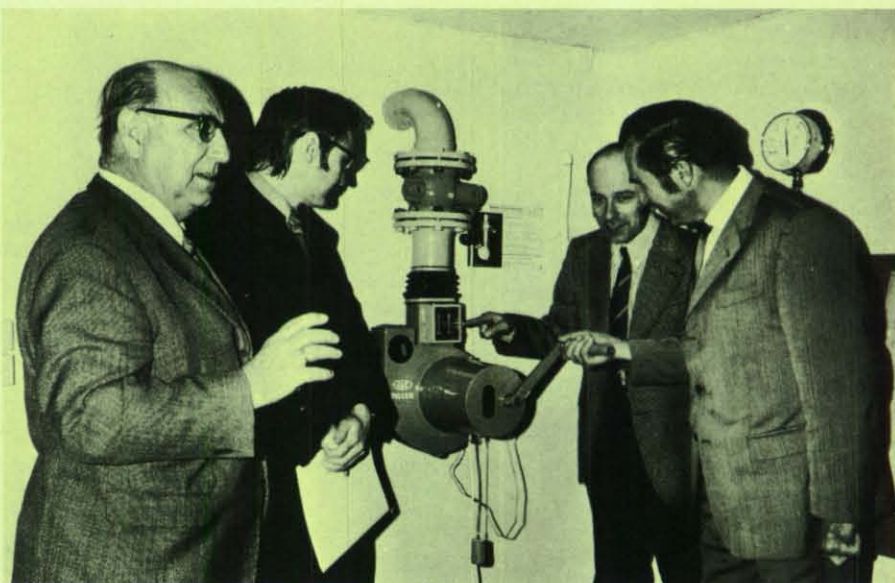
In einem privaten Schutzraum für 25 Personen in einem Neubau in Bremen-Oberneuland hielt die Arbeitsgemeinschaft Schutzraumbau des BVS Bremen eine Arbeitstagung ab. Dabei wurde auch die Luftzufuhr eingehend erörtert und die Wirkungsweise der Belüftung demonstriert. Links der Leiter der Arbeitsgemeinschaft, Fachgebietsleiter Karl Golde.
