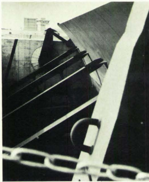
Die Stauschilde der Segmenttore bestehen aus 25 mm starkem Stahlblech. 8 km lange Schweißnähte, zentimeterweise mit Röntgenstrahlen überprüft, verbinden die Sektionen miteinander.
