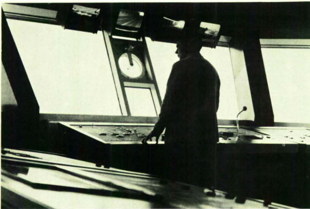
Der Leitstand, die eigentliche Betriebszentrale des Sperrwerks, ist mit den Steuerpulten für Siel, Schleuse, Klappbrücke, Schiffsfahrtszeichen und Beleuchtung sowie einer Reihe von Anzeige- und Registriergeräten ausgestattet.
