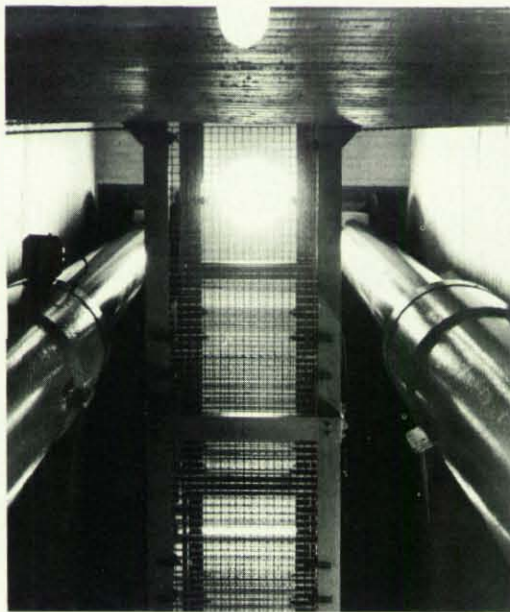
Die Hubzylinder, aus nahtlosem Flußstahlrohr hergestellt, haben einen Innendurchmesser von 455 mm und sind oben und unten kugelförmig gelagert. Mit ihnen können die Sieltore um 6,60 m gehoben oder gesenkt werden.
