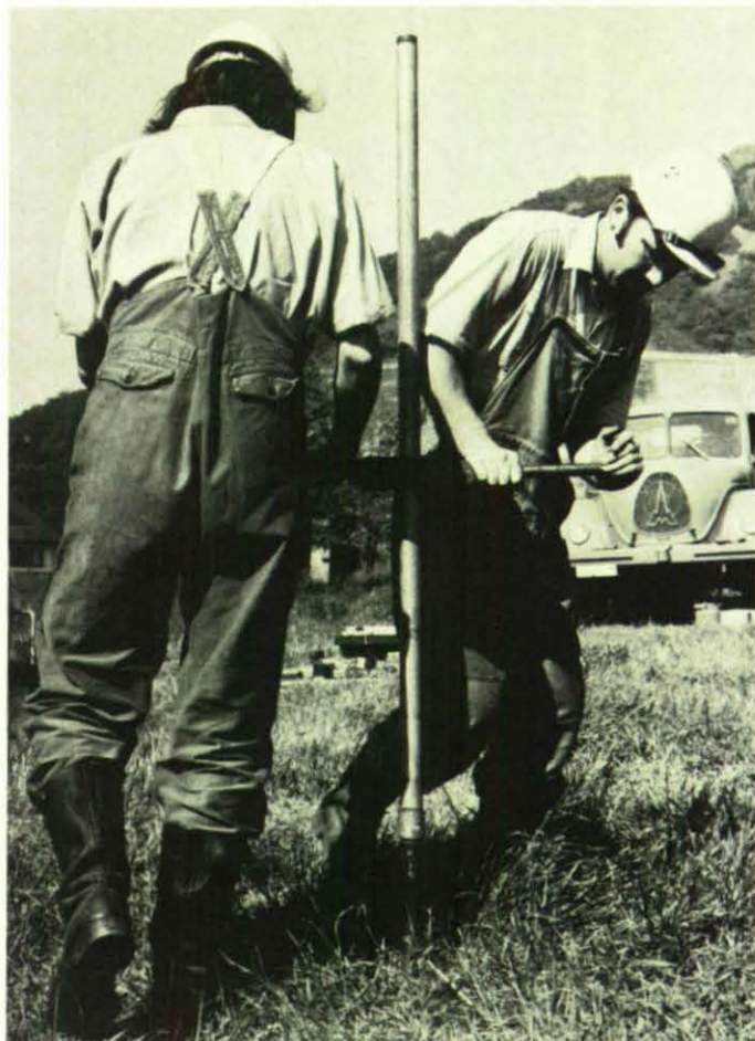
Hier wird das Saugrohr mit dem Erdbohrer bis zum Grundwasser gebohrt. Dabei muß der Bohrer immer wieder gezogen, vom Erdreich gereinigt und verlängert werden.
