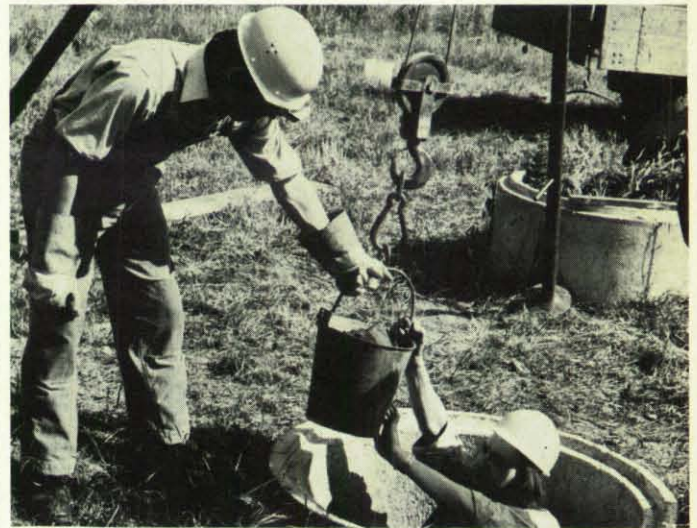
Der Vortrieb eines Schachtbrunnens erfolgt durch Abgraben des Erdreichs im Schachtinnern. Der Aushub wird nach draußen gefördert; die Schachtringe sinken durch ihr Gewicht tiefer.
