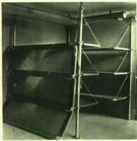
Den Besuchern des BVS-Standes wurde gezeigt, daß die technische Seite des Schutzraumbaus bis in alle Einzelheiten, auch hinsichtlich der Ausstattung — hier die klappbaren Liegen —, gelöst ist.
