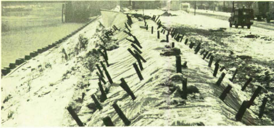
Der Deich ist fachgerecht fertiggestellt. Ein hartes Stück Arbeit liegt hinter den Helfern.
