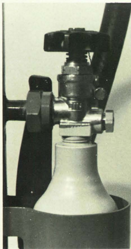
PG 6 H. Außenliegende Treibmittelflasche am Löschmittelbehälter angeschraubt. Handrad durch Plombendraht gesichert.
