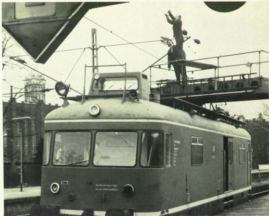
Da die Arbeit an der Fahrleitung nicht ungefährlich ist, gibt es hierfür besonders strenge Sicherheitsvorschriften.
