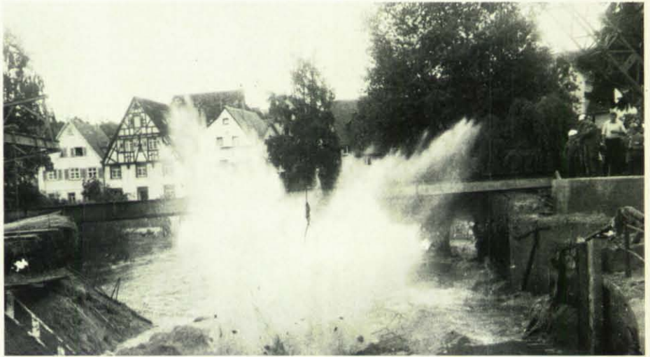
Die Trümmer der eingestürzten Donaubrücke rammt ein Bagger in das Flußbett.
