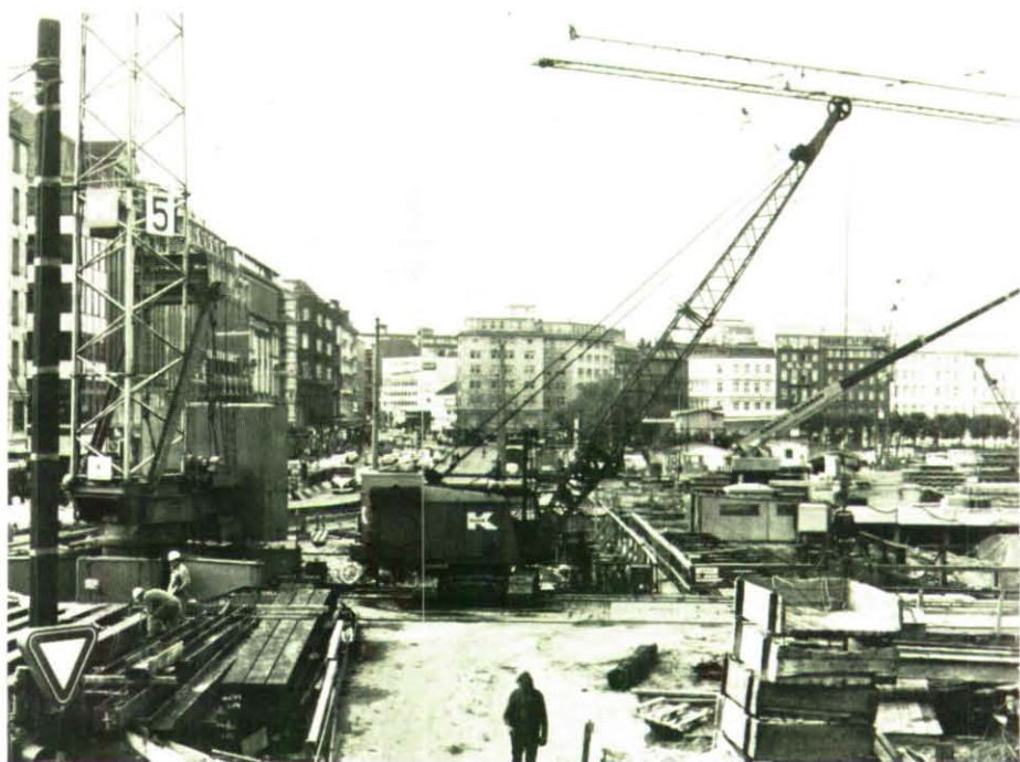
Die Bundesregierung ist bemüht, in möglichst vielen unterirdischen Verkehrsanlagen, wie hier in Hamburg, Schutzräume als Mehrzweckanlagen zu errichten.
