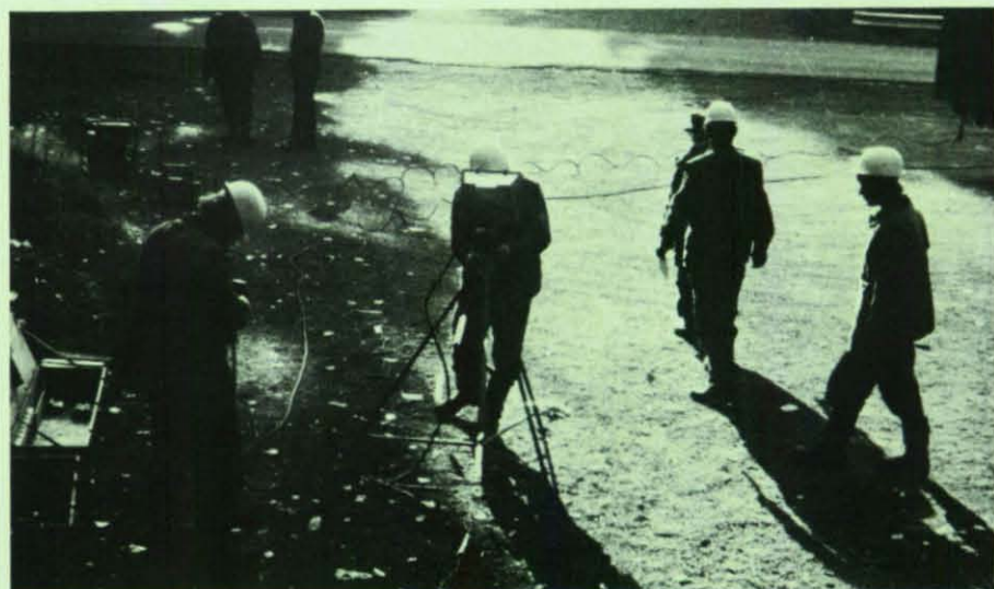
Die nächste Aufgabe wartete am Neuen Teich: es galt, eine Flutlichtanlage aufzubauen.
