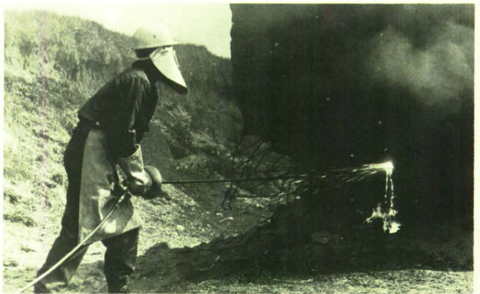
Dem Betonkoloß rückten die THW-Helfer mit der Sauerstoffflanze zuleibe. Betongemisch und Eisengeflecht wurde bei 2000 Grad Celsius flüssig.
