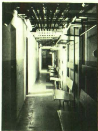
Ein Flur mit schwingungs-isolierten Versorgungsleitungen.
