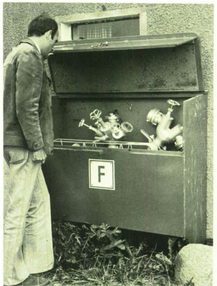
Auf jeder Warft gibt es in zentraler Lage einen Behälter für gebrauchsfähiges Feuerlöschgerät, denn hier sind die Anwohner ihre eigenen Feuerwehrleute.
