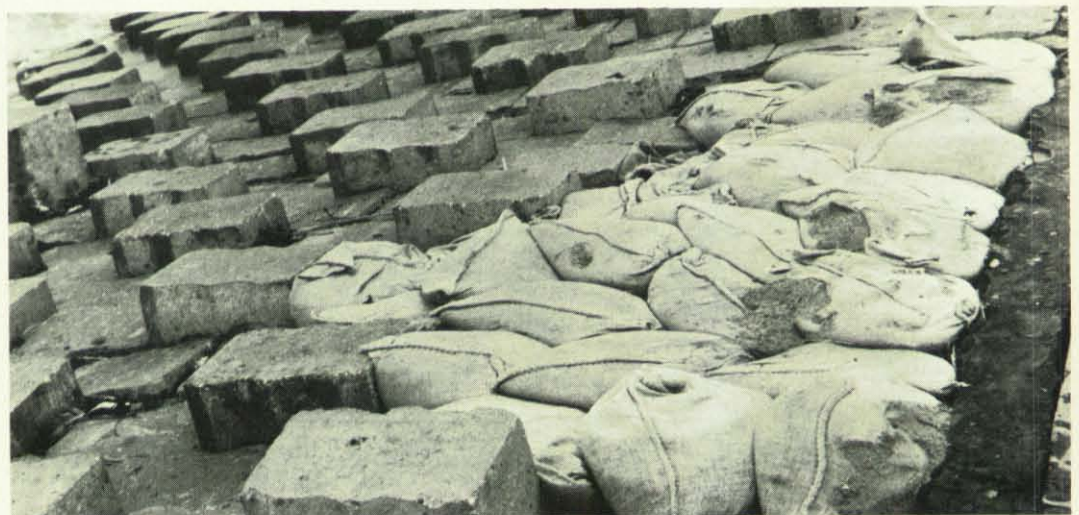
Die ungeheure Kraft der Wellen vermag selbst stabile Deiche zu zerstören. Dann müssen die Schäden sofort provisorisch — wie hier mit Sandsäcken —, aber sobald wie möglich endgültig behoben werden.
