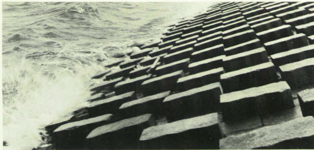
Unaufhörlich rennt das Meer gegen die Ufer von Inseln und Halligen im Nordfriesischen Wattenmeer an. Die besondere Form dieser Steinpackungen soll dem Wasser die Kraft nehmen und den Deich schützen.
