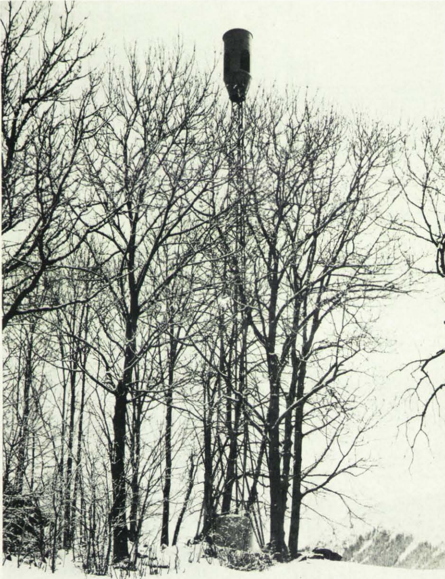
Gesamtansicht einer Hochleistungs-Sirenenanlage mit Leichtbau-Gittermast.
