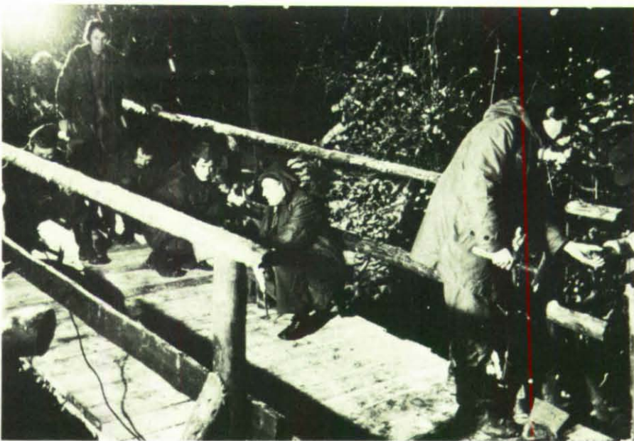
Bei Schneetreiben bauten die Männer vom THW Aachen eine Brücke im Tierpark Trimbörner Wäldchen für die Besucher.
