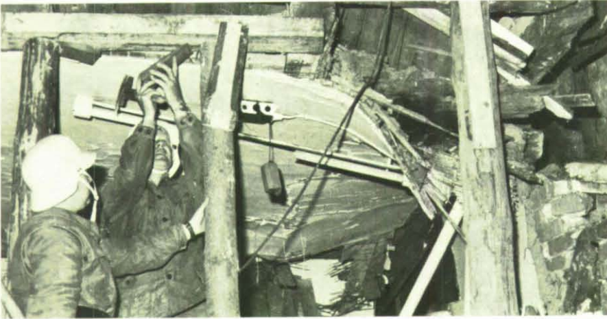
Helfer des OV Uelzen sichern das zerstörte Caféhaus.
