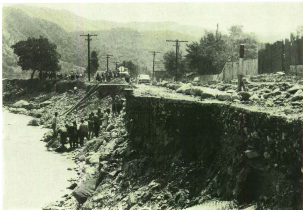
Unterspült und abgerutscht ist dieser Teil der rumänischen Nationalstraße 10.
