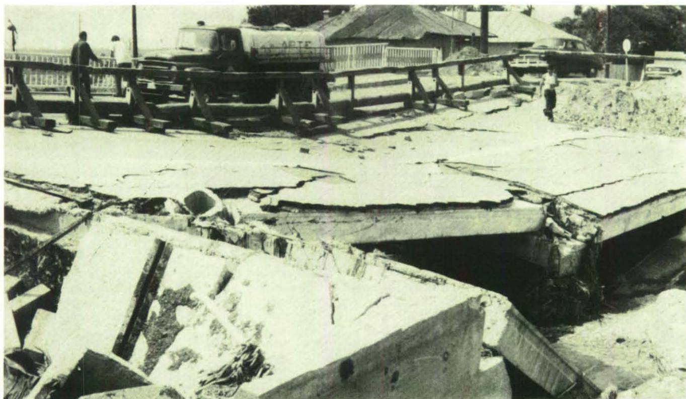
Behelfsmäßig abgesicherte Brücke im Bereich der Nationalstraße 6.
