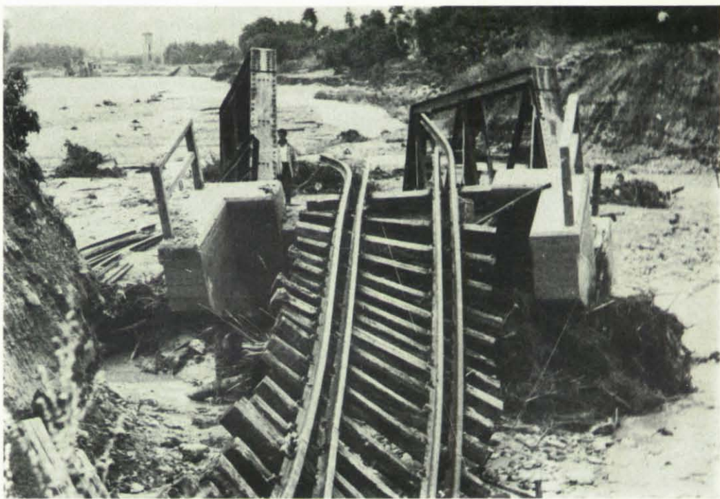
Über 2 500 km Eisenbahnlinie wurden vom Hochwasser in Mitleidenschaft gezogen. 20 Eisenbahnbrücken sind total zerstört worden.
