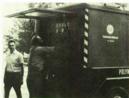
Acht Tage nach der Übernahme wurde das 58-KVA-Notstromaggregat bereits eingesetzt.
