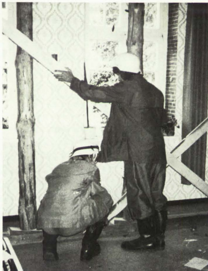
Gefährdete Gebäude mußten oftmals in Blitzaktionen abgesichert werden. Abstützen und Aussteifungen bewahrten vor größeren Schäden.
