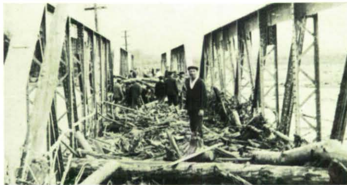
Bis Ende September wurden Eisenbahnstrecken, Straßen und Brücken in den von der Hochwasserkatastrophe betroffenen Gebieten Rumäniens mit deutscher Hilfe instandgesetzt. Unser Bild zeigt den Zustand einer Eisenbahnbrücke nach dem Abflauen der Flutwelle.
