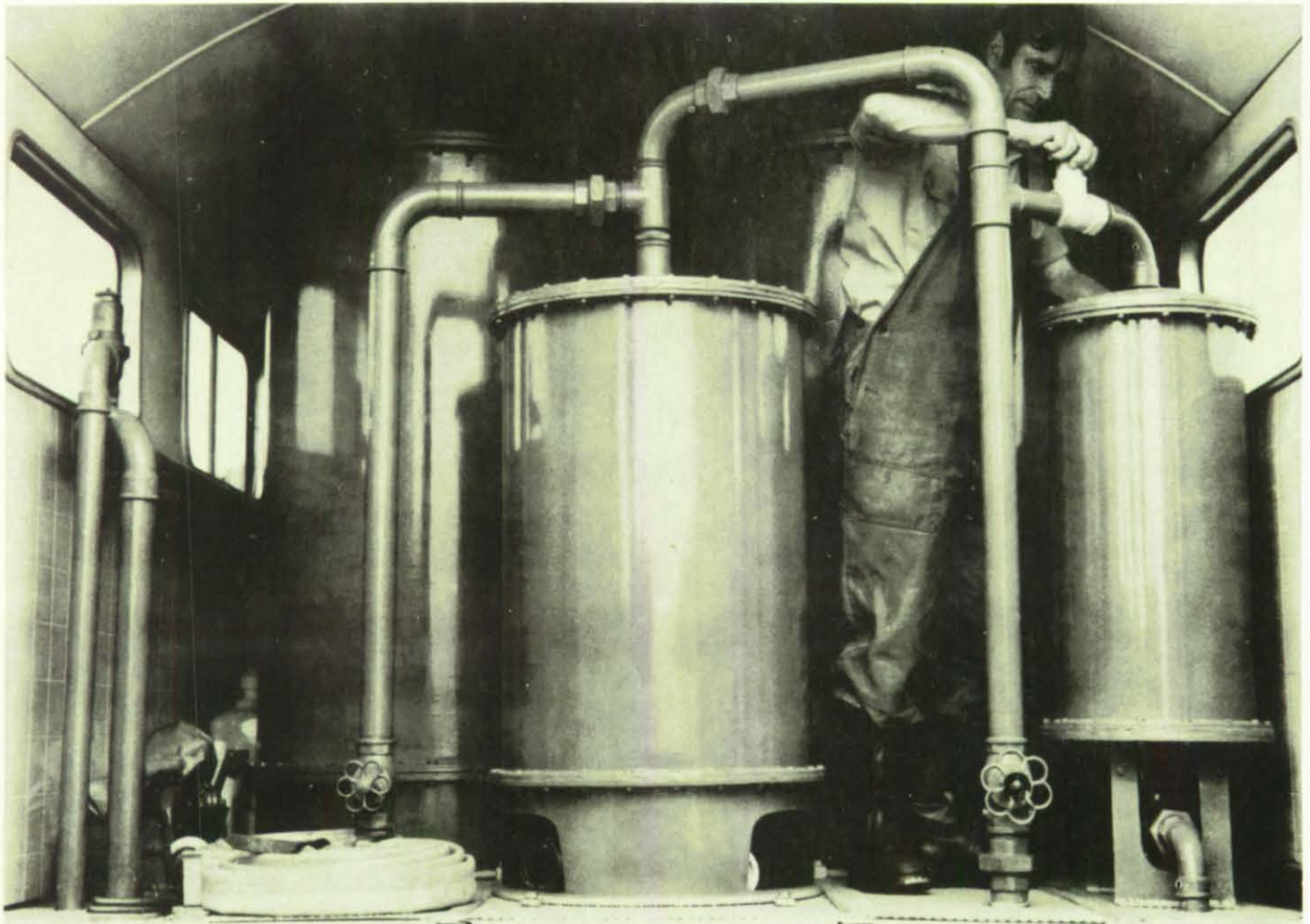
Bild 7: Überprüfen der Ventilstellung vor der Inbetriebnahme. Im Hintergrund die beiden Hauptfilter, davor im Vordergrund Mitte Schönungsfilter, rechts Entgiftungsfilter
