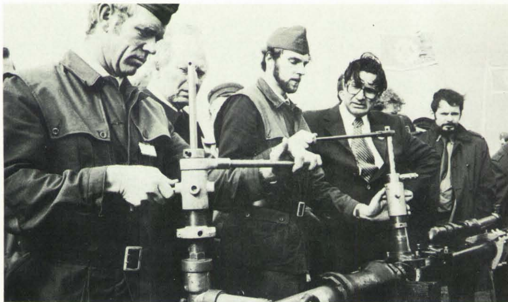
Bundesinnenminister Prof. Dr. Maihofer verfolgte interessiert die verschiedensten Arbeiten, hier den Rohrleitungsbau.
