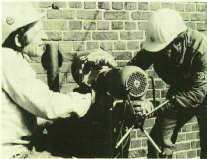
Versuche mit einem großdimensionierten Diamant-Kernbohrgerät an Stahlbeton und Mauerwerk in Hamburg ergaben neue Aspekte für die Bergung aus versperrten Räumen.
