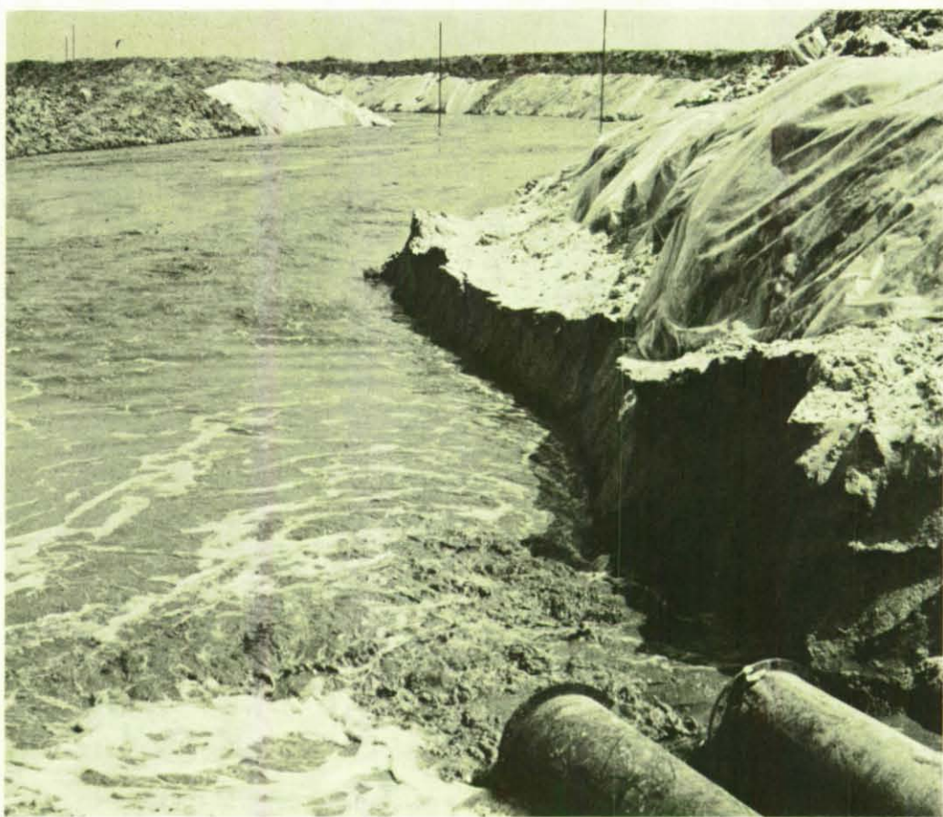
Kunststoff-Folien dichten während der Sand-Spül-Phase die aus relativ lose aufgeschütteter Erde bestehenden Seitenwände ab und verhindern, daß das Wasser durchsickert und sich einen eigenen Weg sucht.
