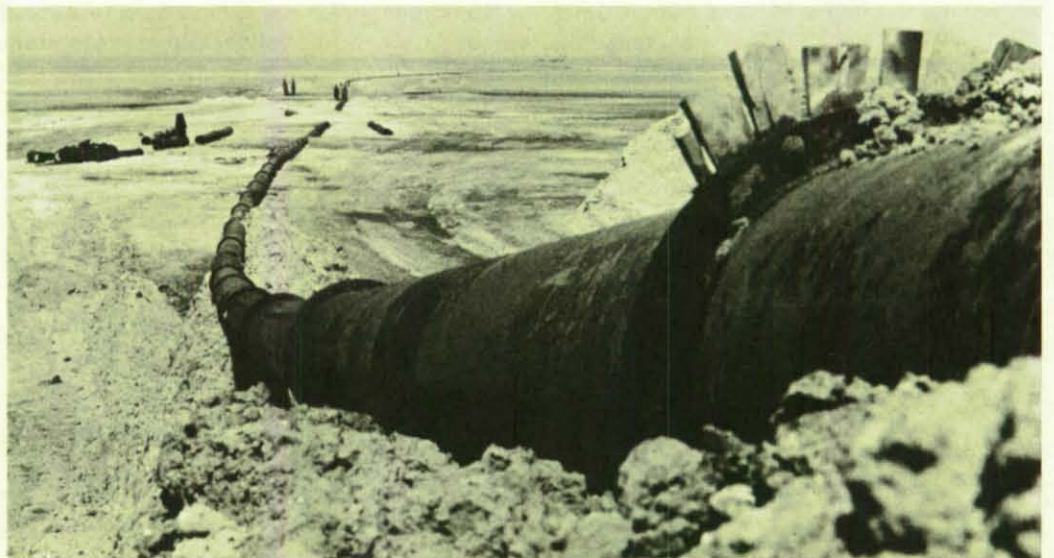
Von einem Saugbagger aus wird Spülsand über eine 1 500 m lange Rohrleitung über das Vorland bis zum Deich gepumpt. Der Saugbagger holt den Sand über eine 180 m lange Saugleitung aus dem Meer.
