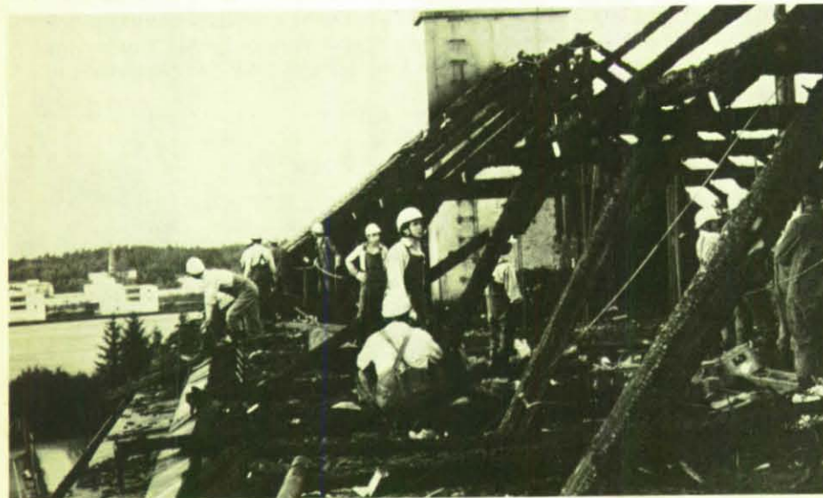
Die verkohlten Reste des Dachstuhls wurden von den THW-Einsatzkräften abgebrochen.
