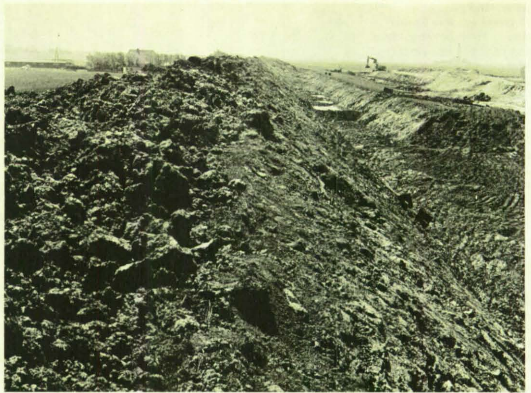
Auf diesem Bild ist der ausgebaggerte Kern des Deichs deutlich erkennbar. Alle diese Bauarbeiten, bei denen der Deich vorübergehend schwächer wird, dürfen nur in der Zeit zwischen März und Oktober ausgeführt werden.
