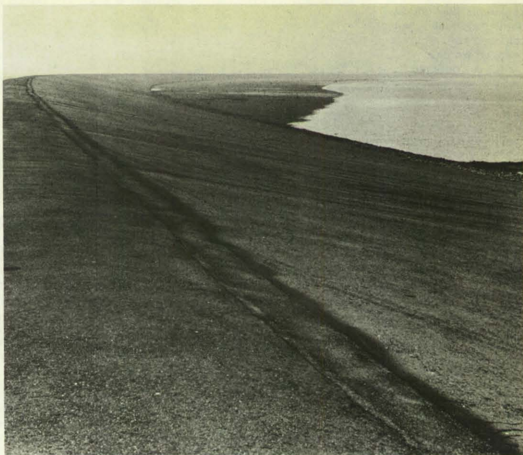
Dieser Deich im Mündungsgebiet der Eider hat eine Asphaltdecke, die auch stärkerem Wellenschlag standhält. Auch Asphaltdecken müssen ständig in einwandfreiem Zustand gehalten werden.
