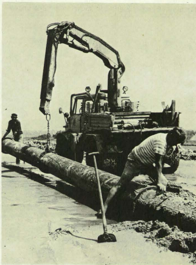
Verlängerung einer Rohrleitung, um in ein weiteres Deichstück Spülsand einzubringen. Die Rohrteilstücke werden angeflanscht. Das Fahrzeug fährt auf kurz zuvor eingeschwemmten Sand, der bereits eine enorme Festigkeit besitzt.
