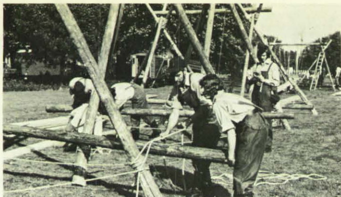
Ein Trümmersteg wurde vom THW-Ortsverband Dortmund für die große THW-Schau auf dem Freigelände errichtet.
