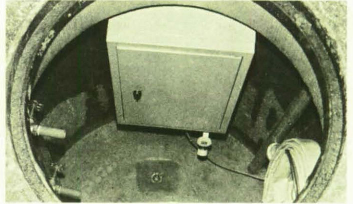
Der Schaltkasten für die Steuerung der Unterwasserpumpe (geschlossen).
