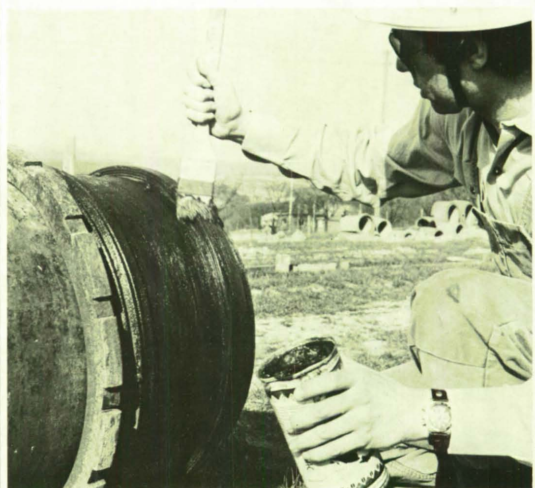
Auf das gesäuberte Rohrende werden Schraubringe und Gummidichtung aufgeschoben und dann das Gleitmittel aufgetragen.
