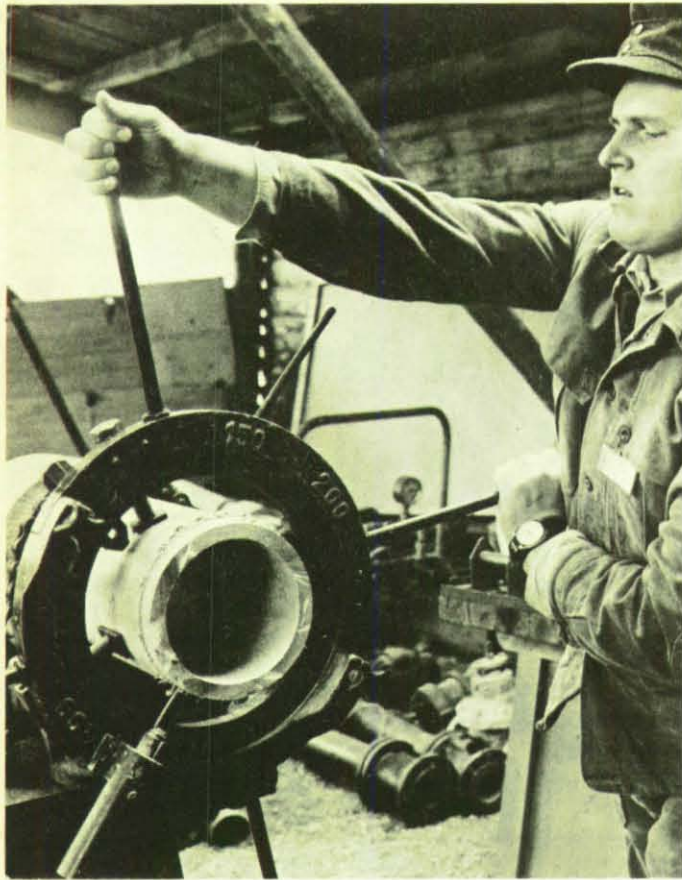
Links: Hier wird ein Asbestzementrohr mit einem Schneidgerät auf die richtige Länge „abgestochen“.
