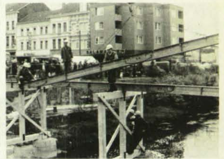
Mit Hilfe eines Auto-Krans werden die Fertigteilträger über die vorgefertigten Holzjoche gelegt und montiert.
