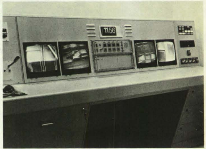
Von diesem Pult in einem Nebenraum aus erfolgt die Bildschirmkontrolle über ferngesteuerte Kameras. Sie dient der Leistungsprüfung und der Sicherheit der Feuerwehrmänner.
