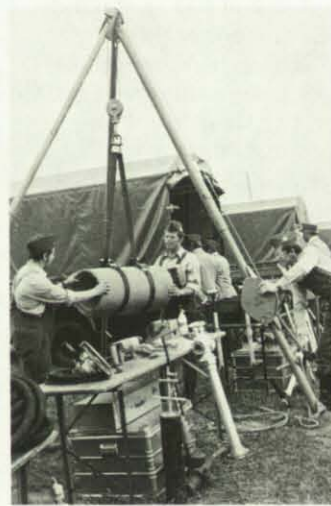
Das Verlegen von Betonrohren für Abwasser gehört zu den Aufgaben des Instandsetzungsdienstes.
