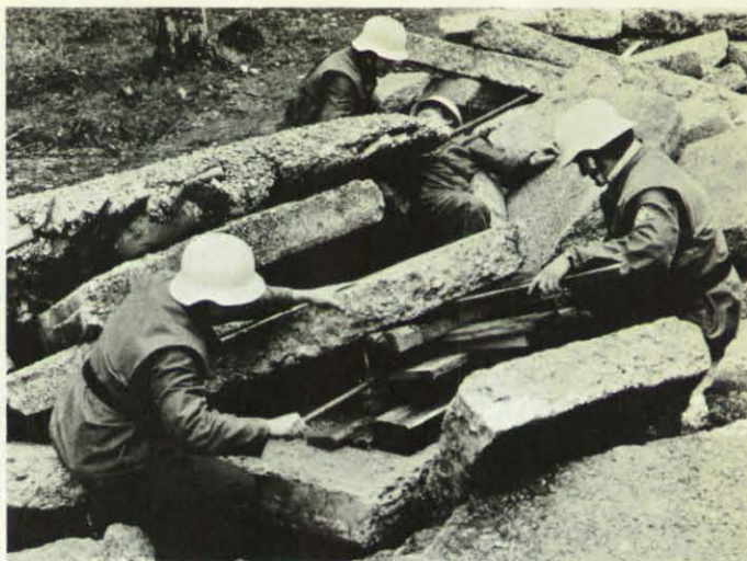
Die Vertrümmerung auf der Rückseite des Betonskelettbaus entspricht der Bauart des Gebäudes. Die großbrockigen Betonplatten mit ihrem großen Gewicht, die in Schichtung übereinanderliegen, stellen bei der Bergung hohe Anforderungen an die Helfer.
