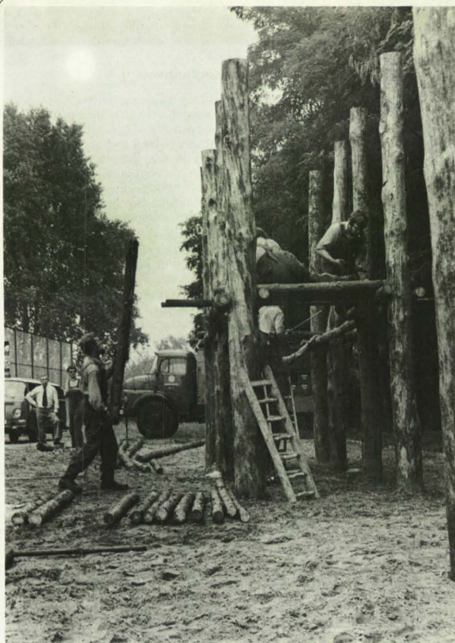
Wichtige Spielplatzgeräte bauten die Helfer des THW-Bezirksverbandes Reinickendorf an der Wittenauer Straße.
