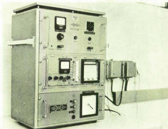
Vollautomatisch arbeitet dieses Gerät der Warnleitmeßstelle im Gymnasium von Burglengenfeld, das direkt mit einem Warnamt verbunden ist und auf Abruf bestimmte ABC-Meßwerte übermittelt.
