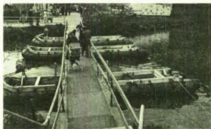
22 m lang war die Brücke, die der THW-Ortsverband Neckargemünd aus Fährenmaterial erstellte.
