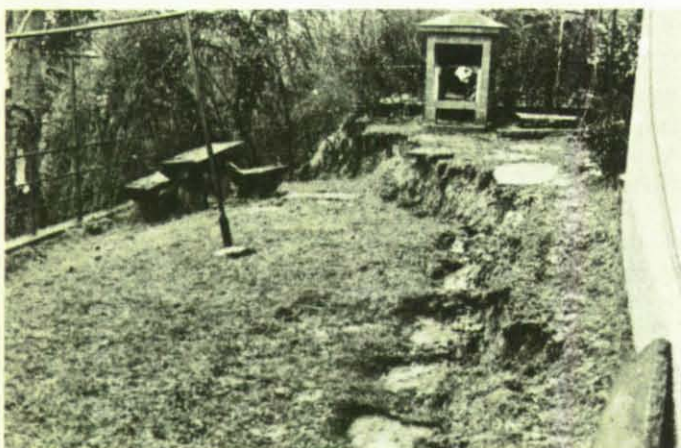
Die Abbruchkante des Steilhangs, der vom THW-OV Waldshut zu sichern war.
