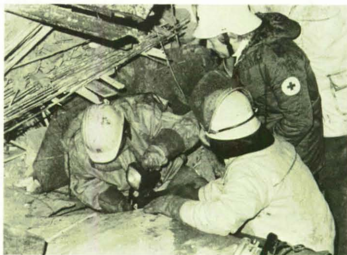
Vorsichtig arbeiten sich die Helfer durch die eingestürzte Kellerdecke nach unten.
