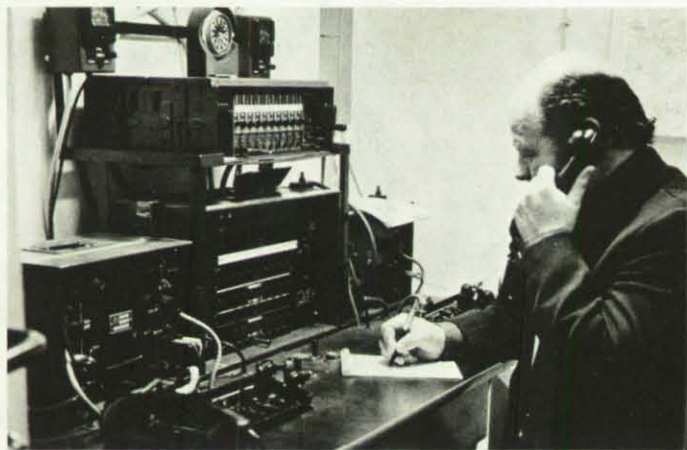
Die Fernmeldezentralen in den drei Abschnittsführungsstellen werden von der Regieeinheit Fernmeldedienst – FMD – betrieben.
