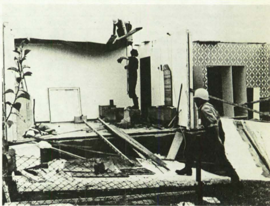
Am 3. August richtete ein Wirbelsturm in Schechingen (Ostalbkreis) schwere Schä-den an: Die Dächer von rund 40 Häusern wurden abgedeckt, dieses Haus (Foto) stürzte wie ein Kartenhaus zusammen. Der Sachschaden ist beträchtlich, Personen wurden nicht verletzt.
