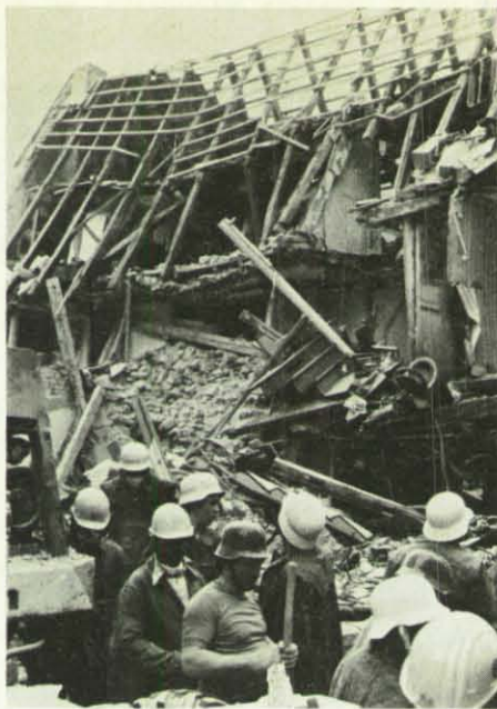
Eine schwere Gasexplosion führte im historischen Zentrum der unterfränkischen Mainstadt Lohr zu schweren Zerstörungen. Ein Menschenleben und viele Verletzte waren zu beklagen. Der Katastropheneinsatz stellte u. a. auch das THW vor schwere Aufgaben.
