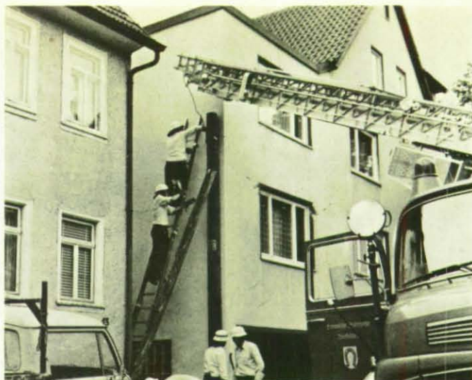
Helfer der Freiwilligen Feuerwehr stützen ein beschädigtes Haus ab.
