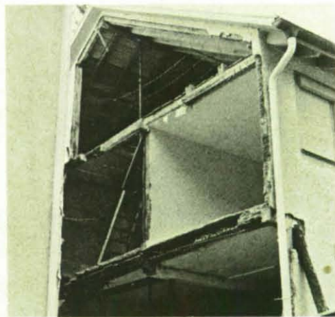
Regelrecht abgebrochen ist die Seitenwand dieses Wohnhauses in Tailfingen.
