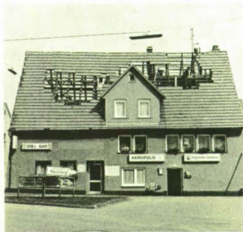
Abgedeckte Dächer – der wohl häufigste Schaden im Erdbebengebiet.
