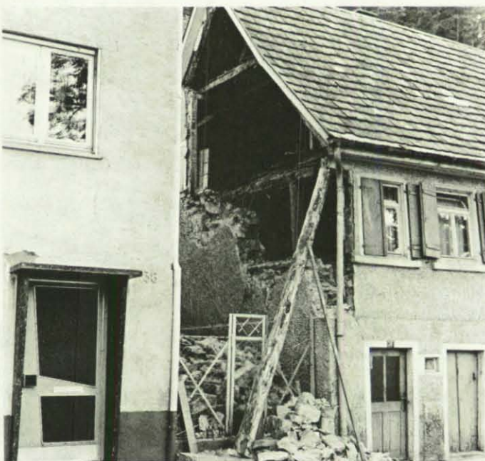
Nach erster oberflächlicher Schätzung wird dieses Haus vermutlich abgerissen werden müssen.
