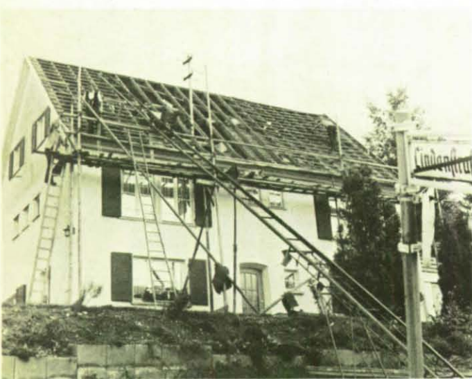
Sicherung und Wiederinstandsetzung der Häuser gingen Hand in Hand. Dachdecker und Maurer hatten Hochkonjunktur.
