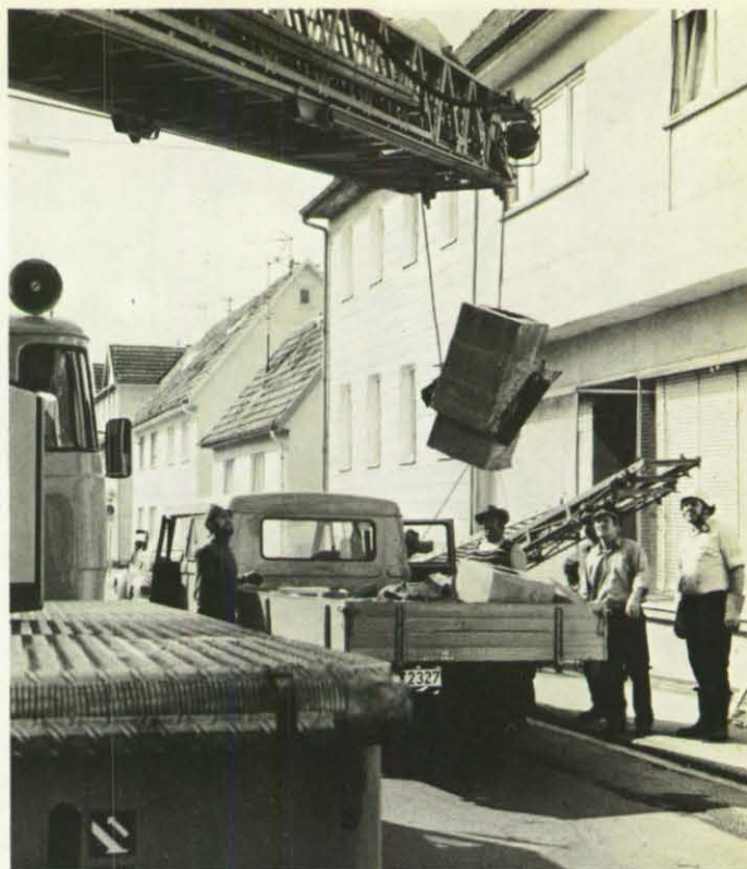
Um weiteres Unglück zu vermeiden, wurden beschädigte Kamine von den Dächern entfernt.
