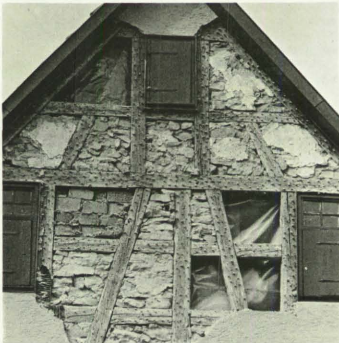
Die Fachwerkhäuser wurden bei dem Beben zwar auch arg in Mitleidenschaft gezogen, hielten den Erdstößen aber doch besser stand als Häuser, die in konventioneller Bauweise aus Ziegeln errichtet worden waren.
