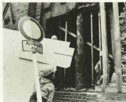
Mit Holzstempeln wurde die beschädigte Hauswand abgestützt, die Öffnung anschließend mit Platten abgedichtet.
