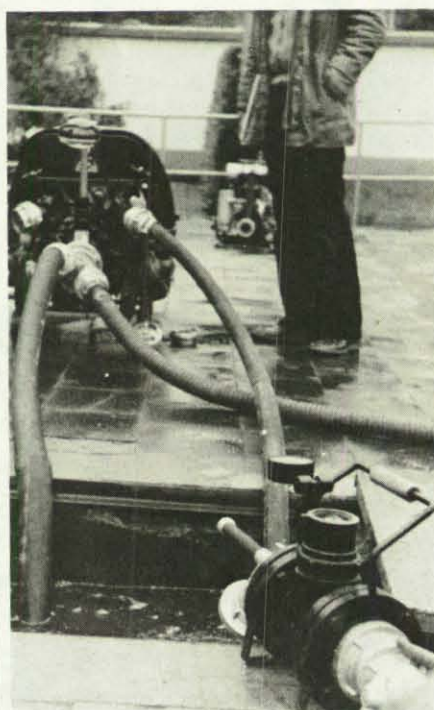
TS 8-Wasserstrahlpumpe mit Treibwasser- und Nutzwasserleitung sowie Rückflußverhinderer.
