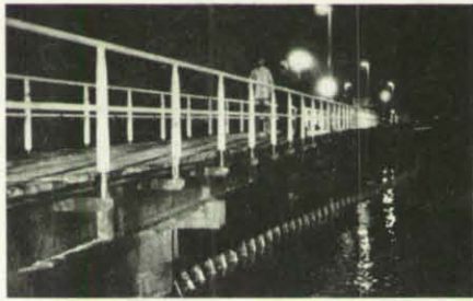
Bei Scheinwerferlicht errichtete das THW noch in der Nacht eine 130 m lange Ölsperre.
