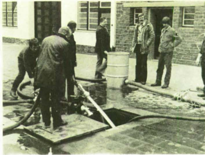
Anlage in Betrieb mit Rückführen des Nutzwassers.
