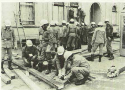
Nach Abschluß der Bergungsarbeiten mußten die THW-Helfer die angeschlagenen Außenwände des Gebäudes abstützen.
