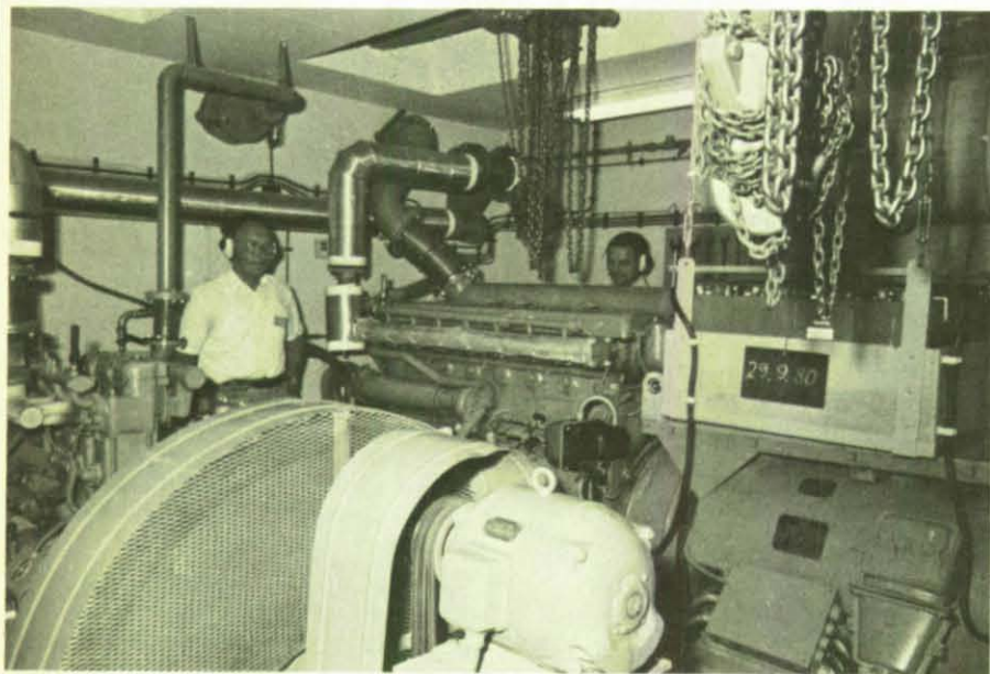
Alle technischen Einrichtungen wurden bei der Warnübung in Betrieb gesetzt. Es gab keine Ausfälle.
