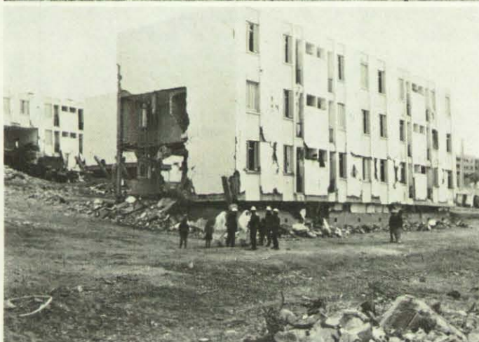
Zusammenbruch eines Stahlbetonbaus: Das Erdgeschoß ist vom Gewicht der drei Obergeschosse erdrückt. Die Betonpfeiler sind nach außen weggeknickt.
