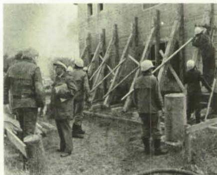
Durch eine Absteifung versuchten die Einsatzkräfte des THW, den Einsturz von Gebäudeteilen zu verhindern.
