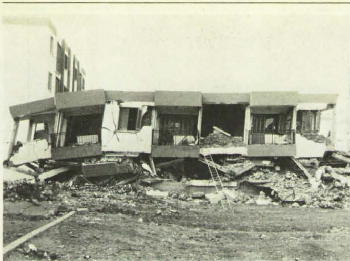
Drei Geschosse sind eingestürzt.
