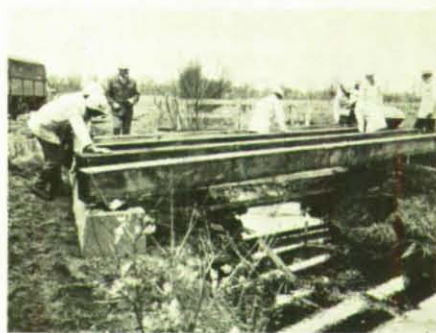
Einen soliden Unterbau erstellten die THW-Helfer für eine Brücke über die Tarpnbeck.
