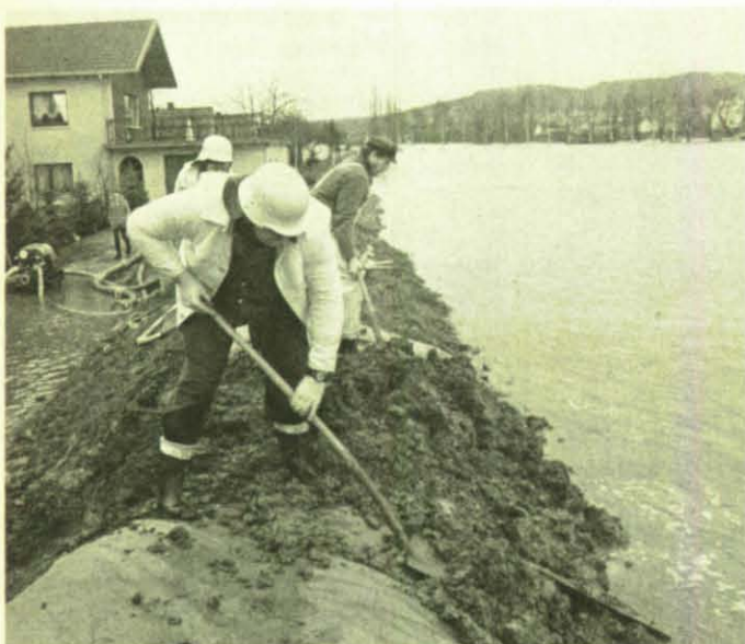
Helfer der Feuerwehr und des Technischen Hilfswerkes waren in Südniedersachsen im Einsatz und reparierten gefährdete Deiche: Unser Foto vom 12. März 1981 entstand in Northeim, wo die Rhume zu einem breiten Fluß angeschwollen war.
