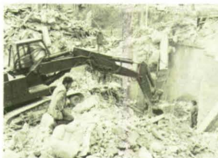
14 Tage nach dem Beben wurden unter diesen Trümmern noch drei ältere Männer unversehrt aus dem Keller geborgen.
