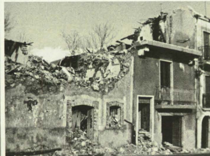
Häuser in Mercogliano – auf Schritt und Tritt die Spuren der Katastrophe, die unvorstellbare Schäden angerichtet hat.
