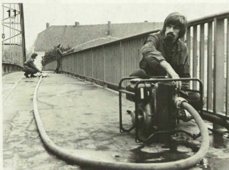
Bild 10: Ist die Saughöhe für die TS 2/5 zu groß, muß eine der drei zur Verfügung stehenden Elektro-Tauchpumpen eingesetzt werden. Mit einer Arbeitsleine sicher geführt, wird die Pumpe abgelassen.
