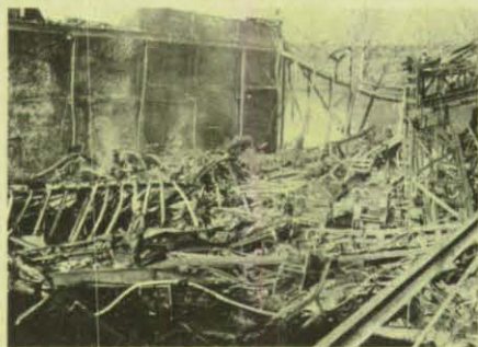
Die gesamte Dachkonstruktion der Halle war bei dem Brand eingestürzt.
