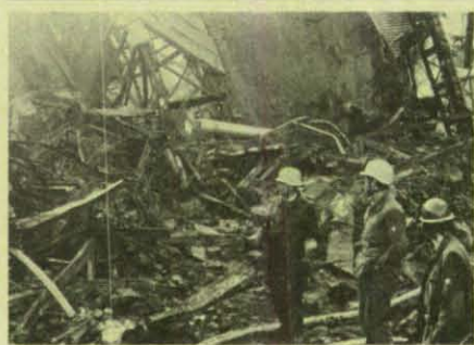
Feuerwehrmänner und THW-Helfer in den Trümmern der Halle.
