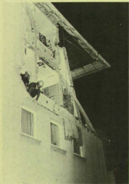
Als erstes erkundeten die THW-Helfer die Schadenstelle.
